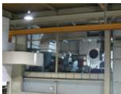
冬期排熱利用ダクト及びブロワー
