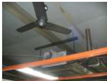
室内攪拌ファン／空調室内機及び真横吹出口
