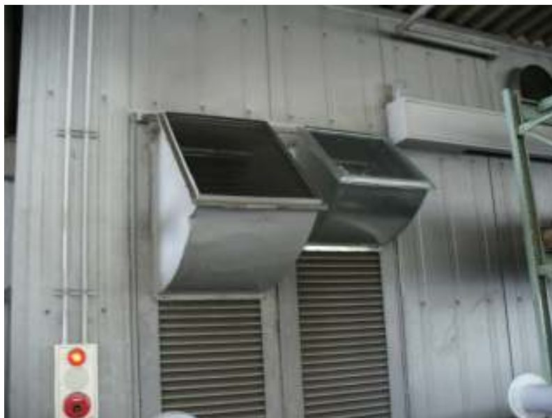
室外吸排気ダクト
