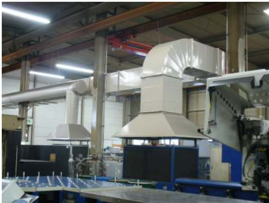
レーザー加工機用排熱ダクト
