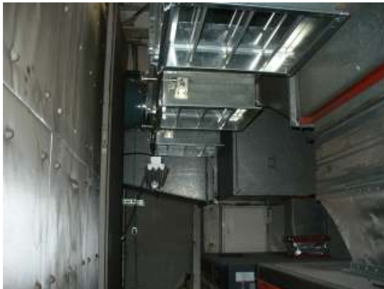
室内排気ダクト及びブロー
