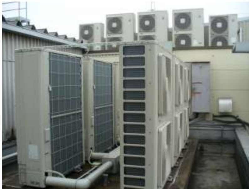
パッケージエアコン13台設置
