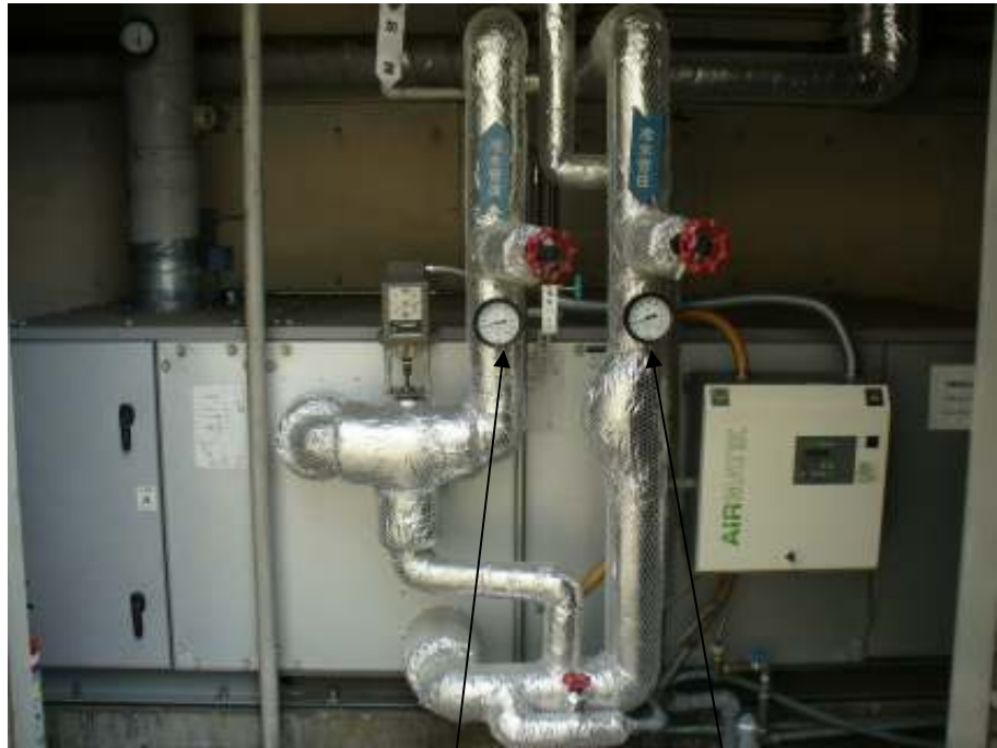
熱交換機ユニット
